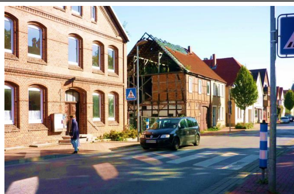
Foto 1: Blick in die Lange Straße und den östlichen Teil des Grundstücks mit Brandschaden
